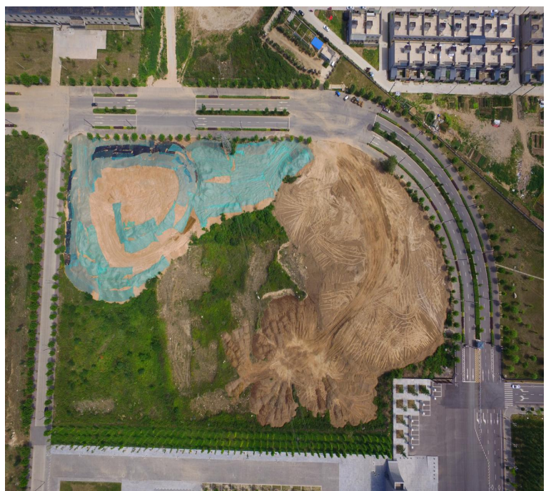
黄土回填：草堂校区东大门西北角环境整治绿化工程黄土回填历时 38 天，回填黄土 8464 车，总共 143035m 3
